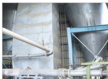
Ciclone revestido em uma planta de cimento
